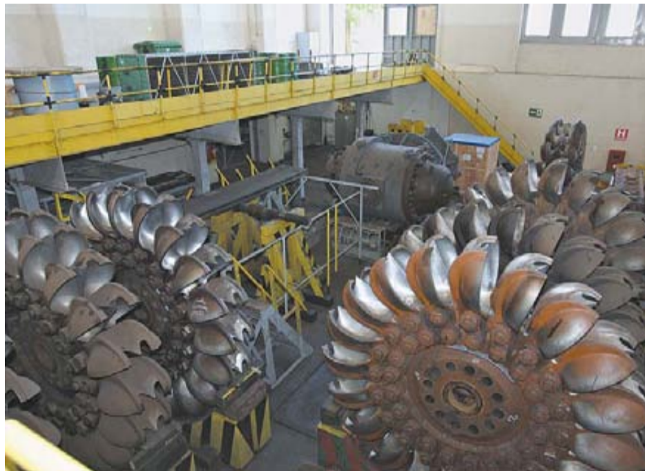
Água que movimenta as turbinas (acima) desce a Serra do Mar através de tubulações
